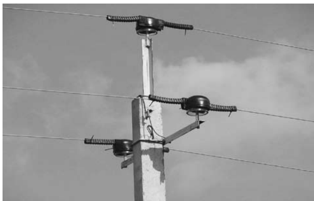
Опора ВЛ-10кВ, оснащённая ПЗУ КП-1Б
