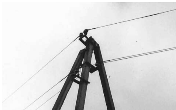
Птицевозрастная опора ВЛ-10 кВ
