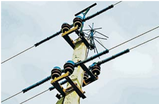
Рис. 1. Вариант птицевозащитного комплекса управления поведением птиц на анкерной опоре ВЛ 10 кВ, составленного из трёх ПЗУ (изолирующего, антиприсадочного и насестного типов). Фото из фондов ООО «Эко-НИОКР» ( https://birdprotect.ru/ )
