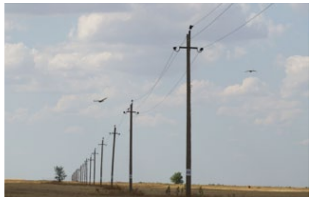
Вдольтрассовая ЛЭП (ВЛ 10 кВ) магистрального газопровода «Средняя Азия – Центр».
