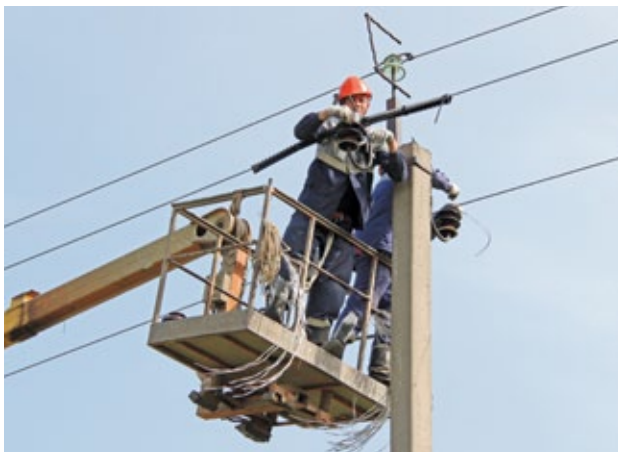
Оснащение ПЗУ вдольтрассовой ЛЭП газопровода «Средняя Азия – Центр» в Палласовском районе Волгоградской области.
