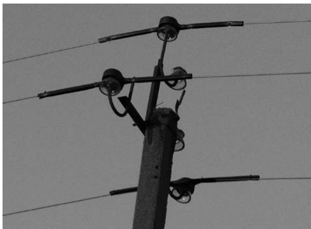
Птицезащитные устройства на ЛЭП. Смоленск
