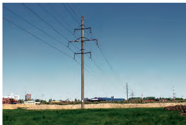
Рис. 2. Опоры ЛЭП высокой мощности (110 и более кВ).
